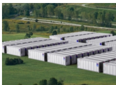
集装箱式储能柜
