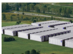
集装箱式储能柜
